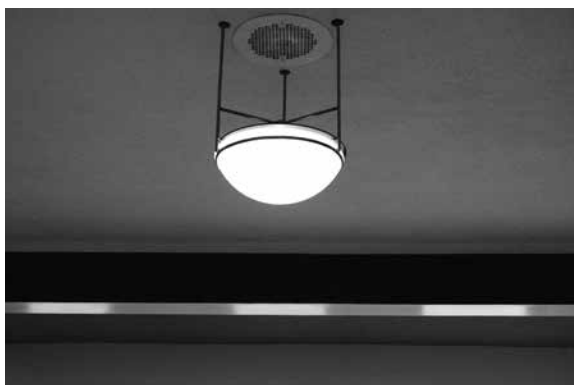
写真 9 廊下の照明器具
